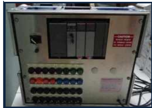
Allen Bradley SLC 5/03
