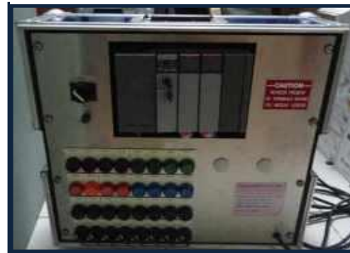
Allen Bradley SLC 5/03
