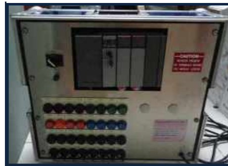
Allen Bradley SLC 5/03
