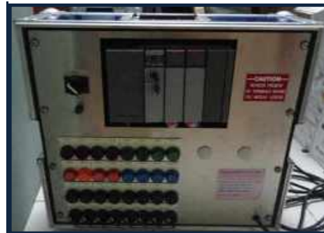
Allen Bradley SLC 5/03
